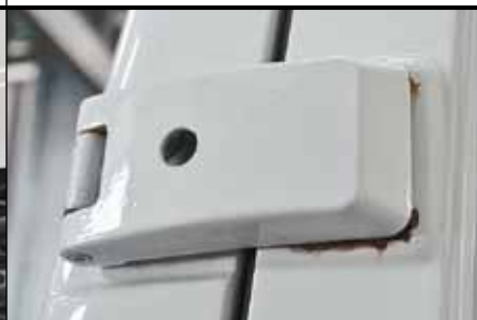
...но около петель металл изгибается – в покрытии образуются трещины
